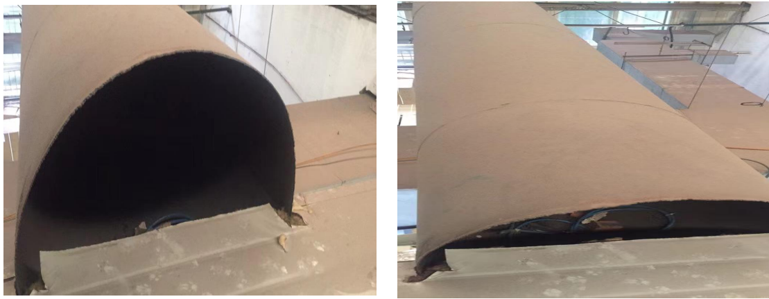
6#排气筒隔断情况
